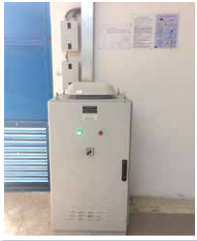
RTU Panosu Dış Görünümü
