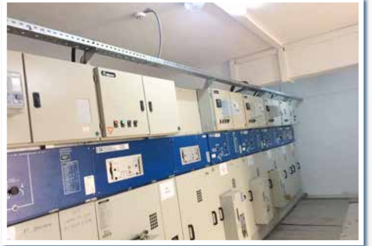
SCADA Kapsamındaki Örnek İstasyon Merkezi
