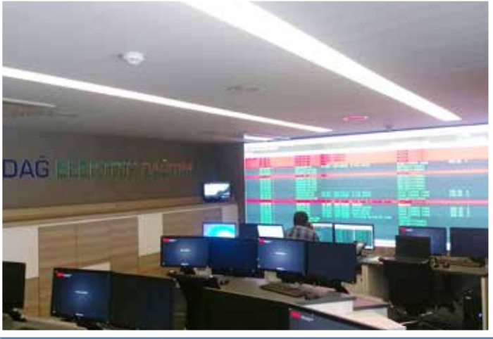
SCADA Ana Kontrol Merkezi
