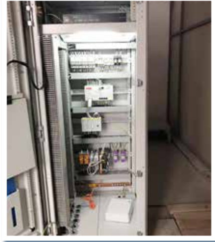
RTU Panosu İç Görünümü
