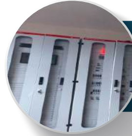
depolama tesisi panosu
